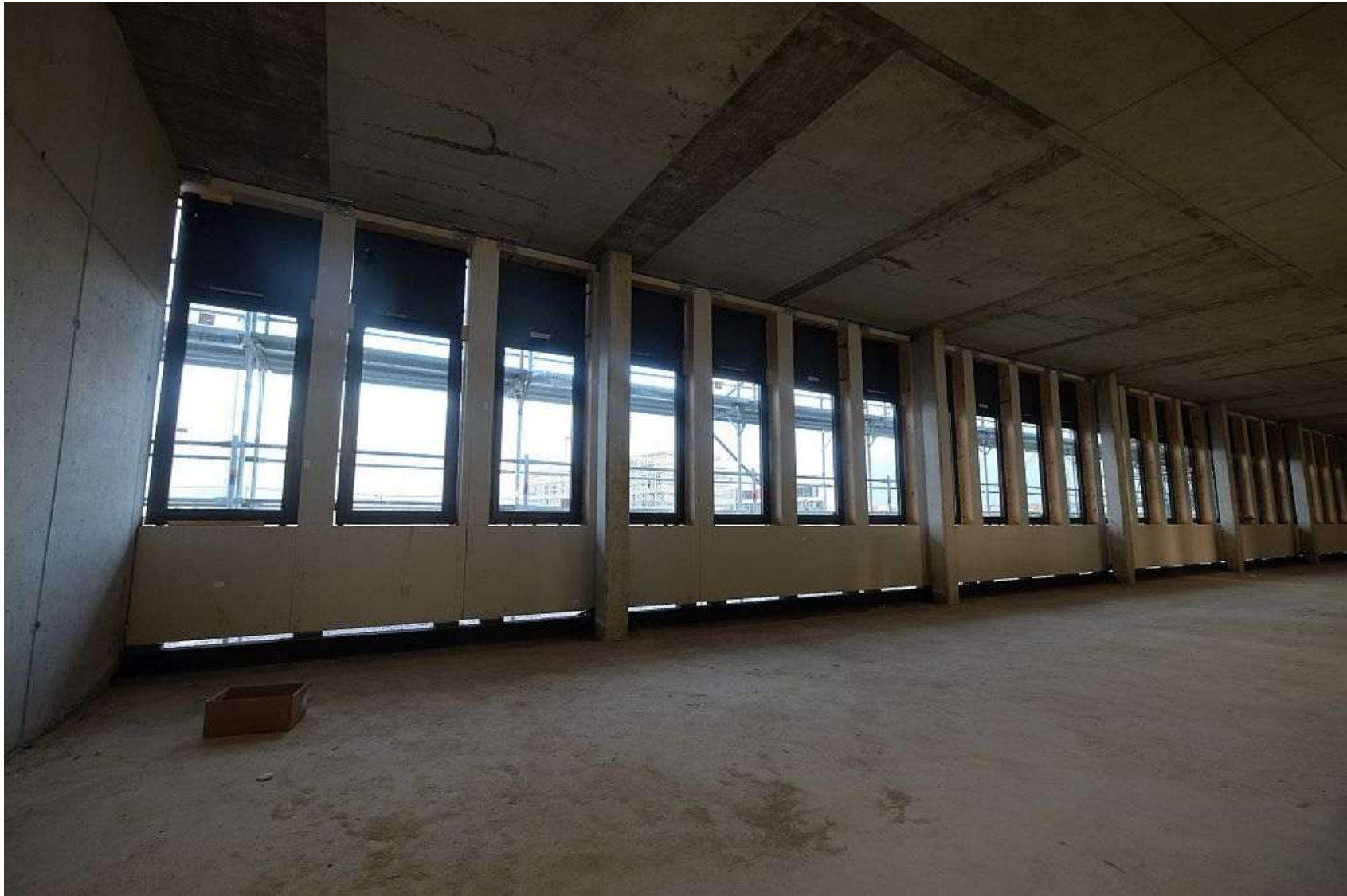
Luftdichte Gebäudehülle gerät zum Problem
